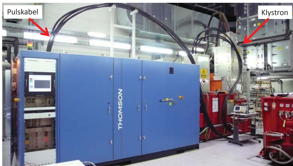
RF-Station mit Thomson Modulator und 5MW Klystron
