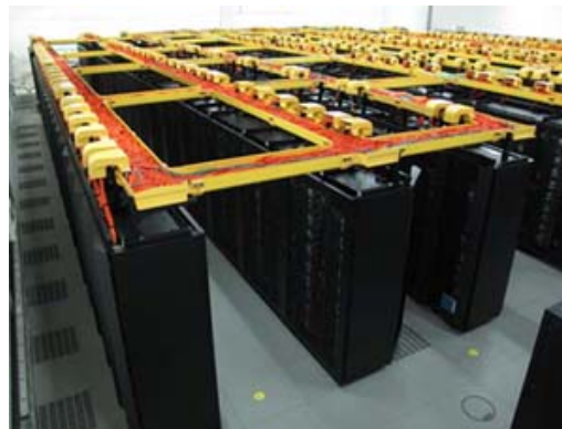
2012: IBM x IDataPlex SuperMUC PRACE@GCS@LRZ
