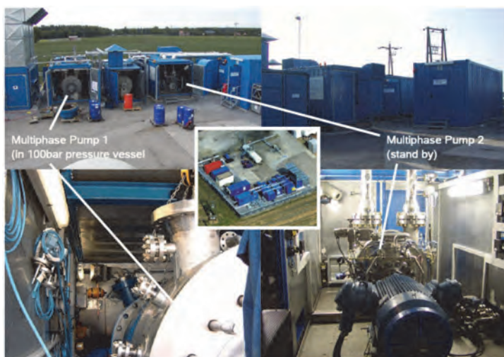
Abbildung 2 : Multiphasen Versuchsanlage Rütenbrock
