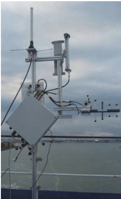
Abbildung 5.14: Sendemast mit Sektorantennen
