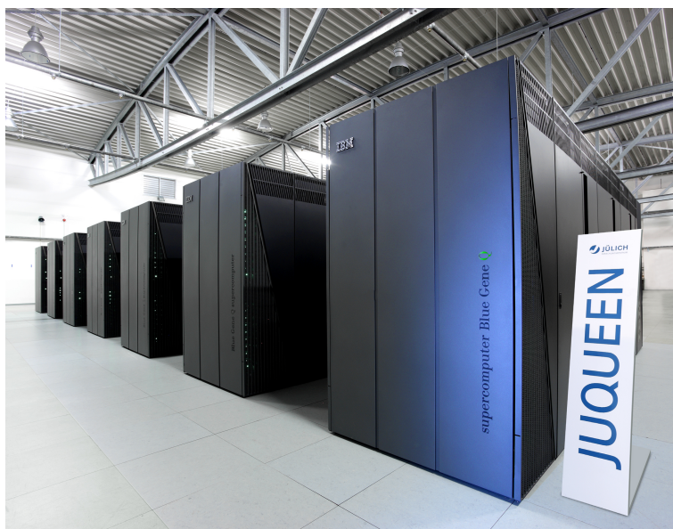
Abbildung 3.1.: Der Supercomputer JUQUEEN in der Rechnerhalle des Jülich Supercomputing Centres. Quelle: Forschungszentrum Jülich
