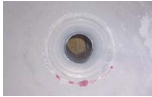
Abbildung 14: Foto von innen auf den Übergang Liner/Anschlussstück nach Farbeindringtest
