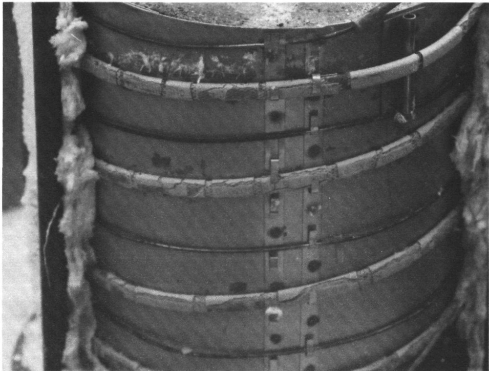
Abb. 18: Lokale Korrosionserscheinungen am Blechmantel und dem Metallmantel-Heizkabel aus austenitischem Cr-Ni-Stahl mit der W.-Nr. 1.4541
