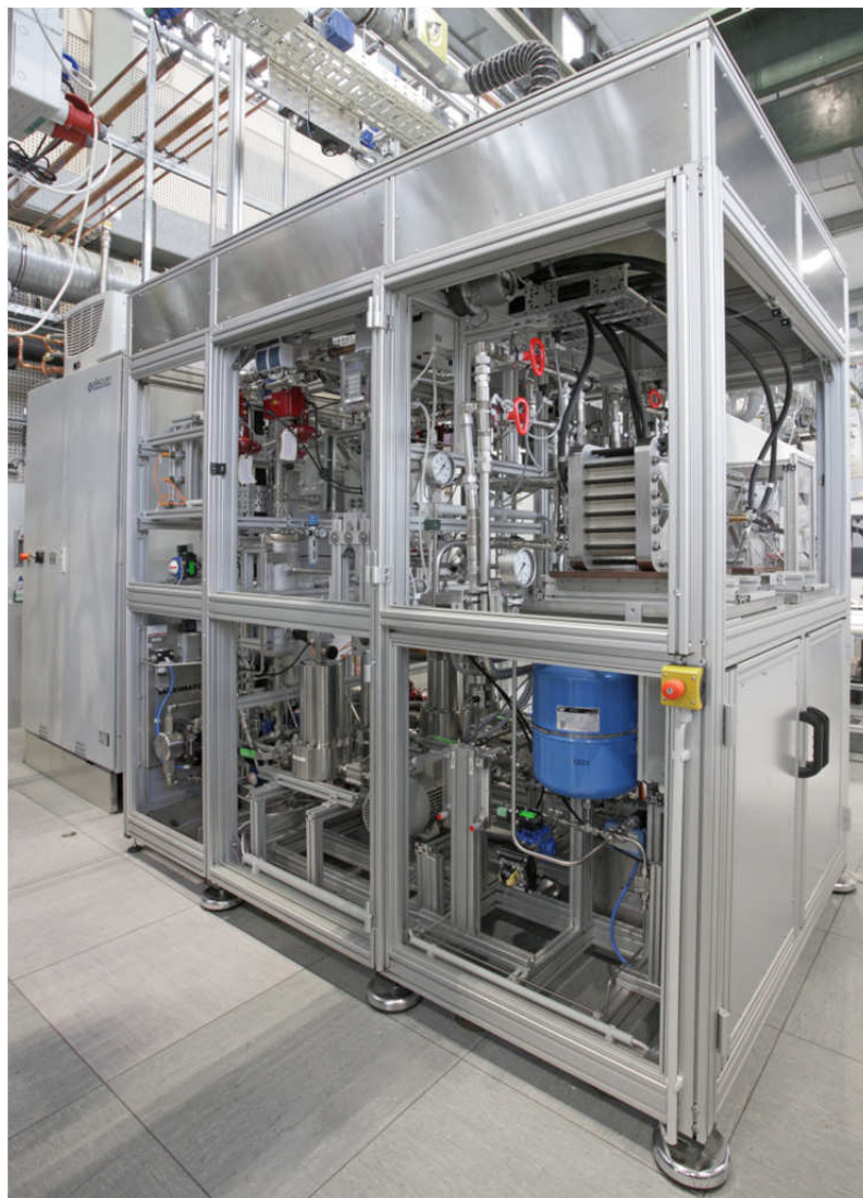
Abbildung 23: 100 kW PEM-Elektrolyseteststand des IEK-3
